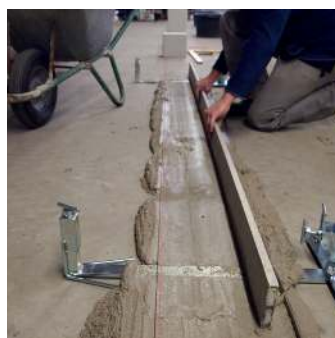
Prolongement du lit de mortier à l'aide du déplacement des accessoires de pose
